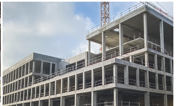
Poteaux grande hauteur
